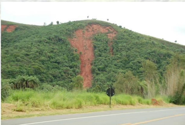
Figura 4.1 - Deslizamento de solo em área não ocupada, Guaratinguetá, SP. Foto: IPT/CTGeo.
