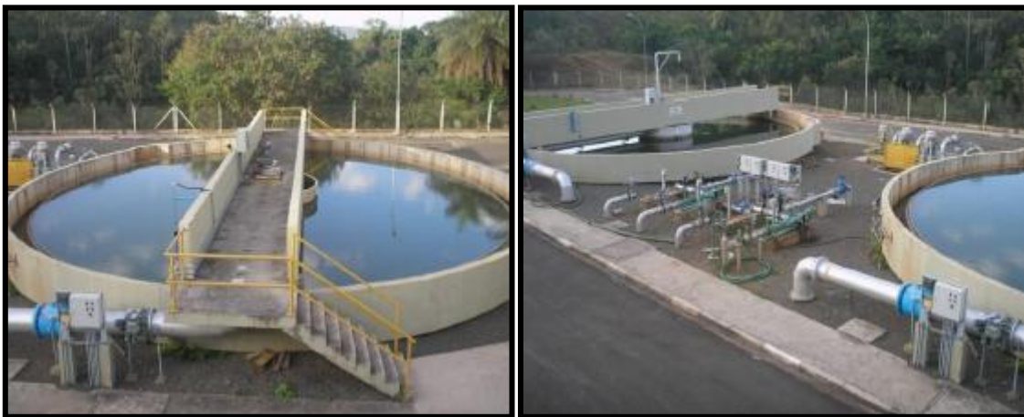
Figura 4.12: Adensadores por gravidade instalados na ETL das ETA 3 e 4 da SANASA na cidade de Campinas. Fonte: SANASA (2013).
