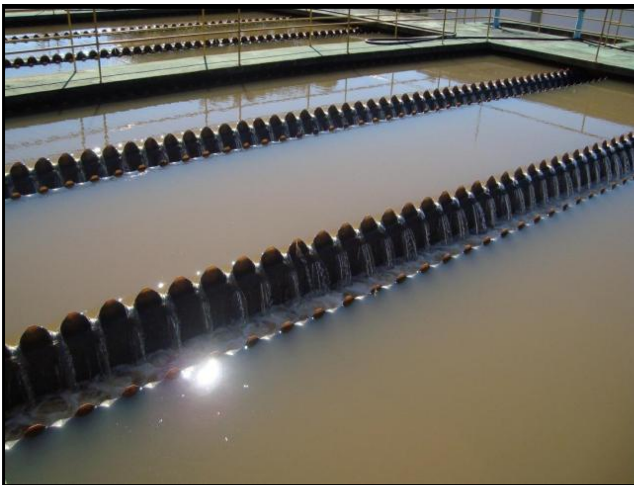
Figura 4.4: Pré-sedimentador de Fluxo Ascensional das ETA 03 e 04 Fonte: SANASA (2013).
