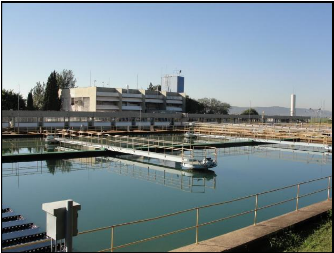
Figura 4.6: Decantadores da ETA 03. Fonte: SANASA (2013).
