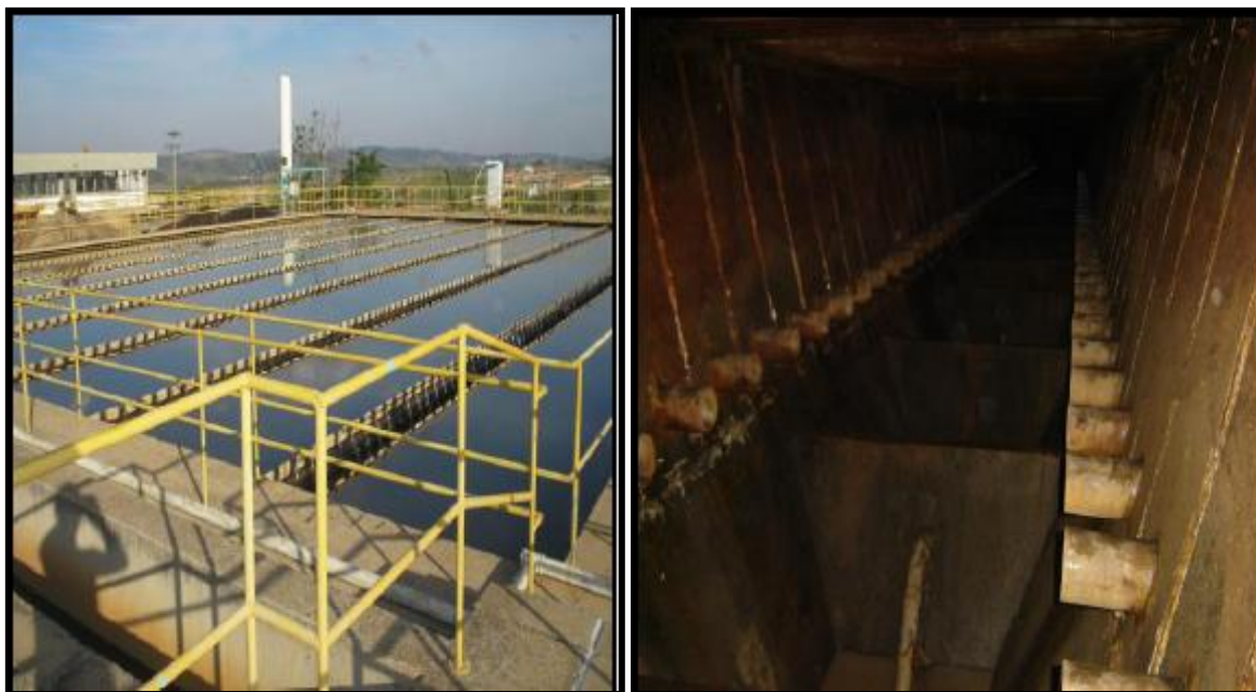
Figura 4.7: Área Superficial do Decantador da ETA 04 (Esquerda). Parte Interna do Decantador (Direita). Fonte: SANASA (2013).
